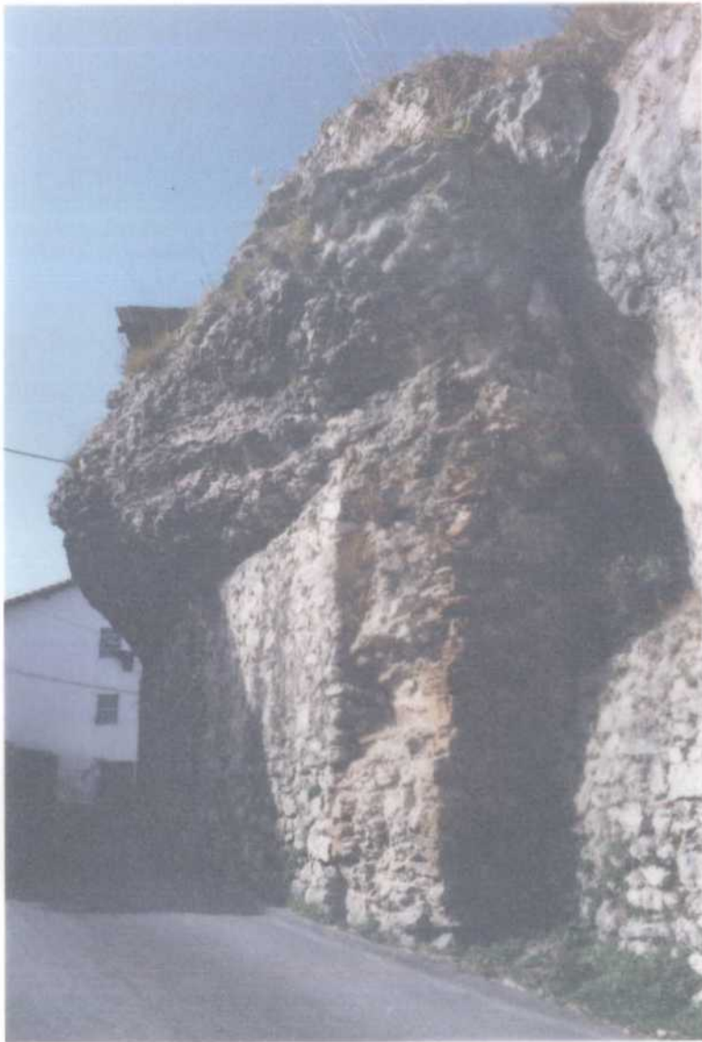
FOTOGRAFIA 3. Vista desde el ángulo opuesto a la anterior de la roca inestable.
